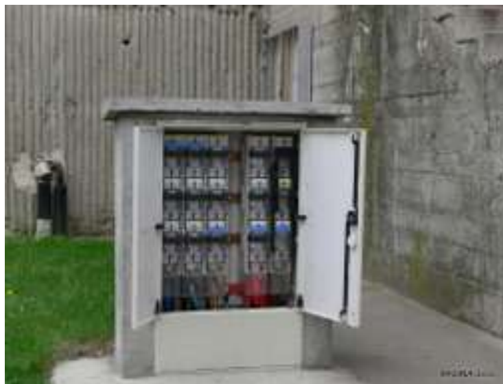
Slika. Izgled niskonaponskog razvodnog ormara sa 6 izvoda »NKRO6«
